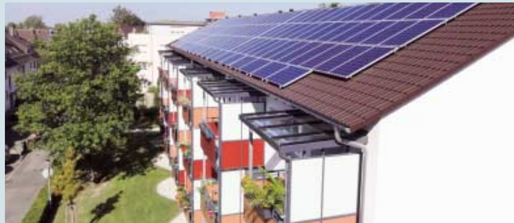
Photovoltaik-Anlage der BürgerEnergiegenossenschaft Region Karlsruhe Ettlingen eG, Hasenbergweg 9a/11, Ettlingen
